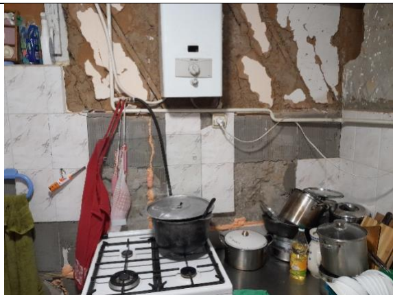
Schade van eerdere granaatinslag in de keuken was hersteld. In muren e.d. veel kogelgaten.
